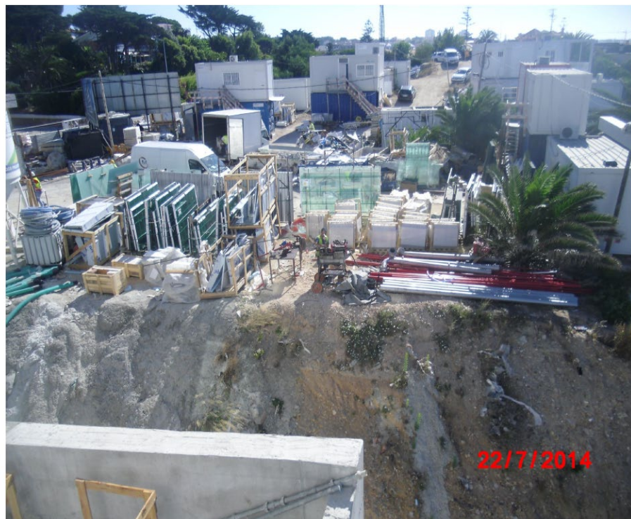
Figura 11. Como se pode observar nesta fotografia quase todo o terreno, nas zonas mais aplanadas, foi utilizado como estaleiro da obra do Hotel Intercontinental sem qualquer restrição e com as devidas licenças.
